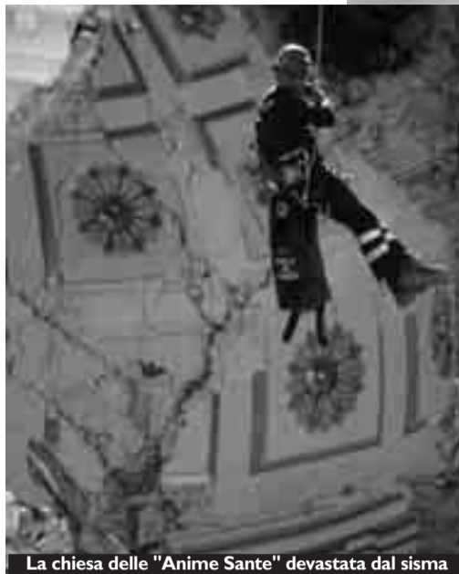
La chiesa delle "Anime Sante" devastata dal sisma
